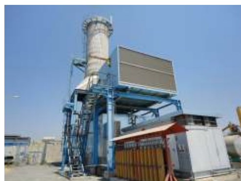
Ein zusätzlicher Generator mit Anbindung an das Stromnetz
